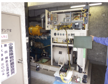
制御盤故障に伴う自動始動盤 仮設調査
