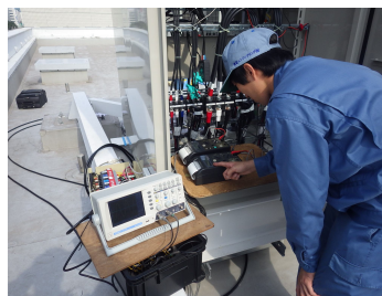
電源切換試験
